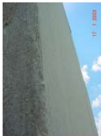
Foto 2: Reparo em fachadas, com emprego de tela de poliéster sobre a parede antes da pintura acrílica.
