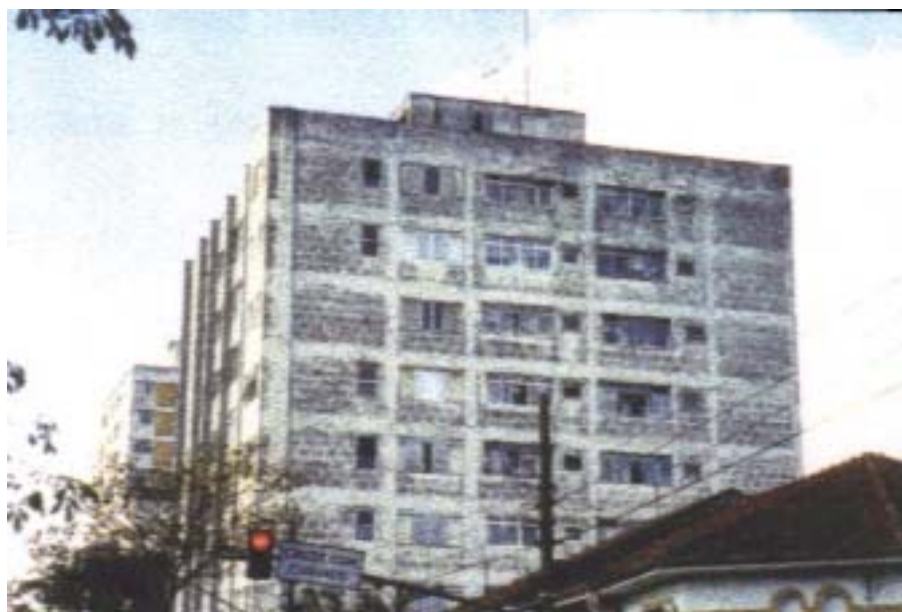
Foto 8: “Desenhos” na fachada provocados por diferenças de comportamento da alvenaria e da estrutura. (THOMAZ, 2002).
