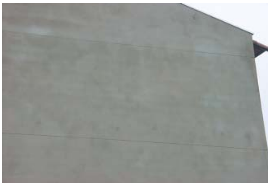
Foto 9: Mapeamento dos blocos no revestimento em função da pouca espessura do revestimento (Obra “O” – Estudo de Caso).
