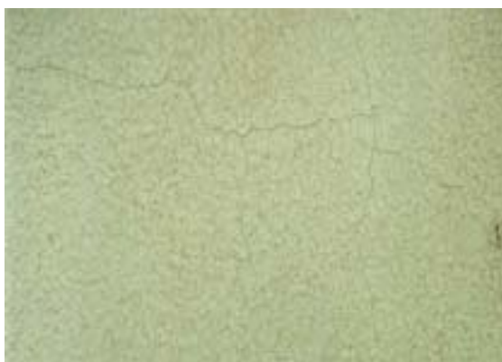
Foto 7: Detalhe de fissura em argamassa de revestimento por movimentação térmica (THOMAZ, 2003).
