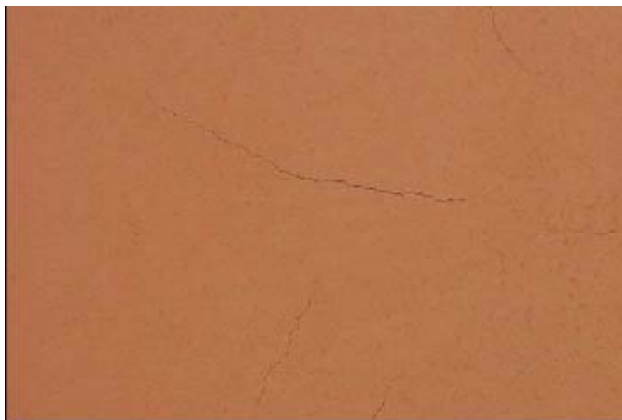
Foto 6: Fissura pronunciada no revestimento em função do assentamento plástico/descolamento, expansão da argamassa de assentamento (sulfatos, presença de material argiloso na argamassa etc) - Obra “O” - Estudo de Caso.
