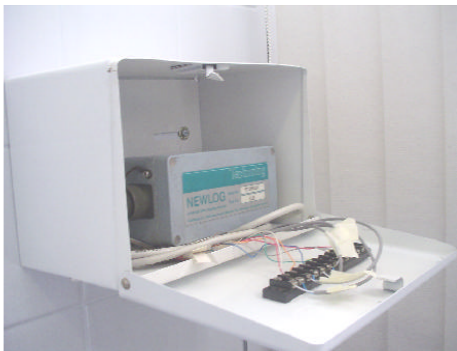
Foto 10: Detalhe do “ data logger ” no interior do abrigo.
