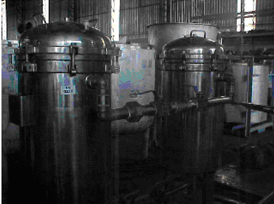
Fotografia 1. Modelo do filtro sparkler utilizado na purificação do concentrado de minério de cloreto de potássio Fonte: O autor (2006)
