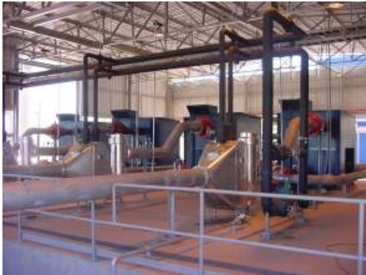
Figura 7: Blowers (tratamento do gás) Fonte: Biogás Energia Ambiental (2008)
