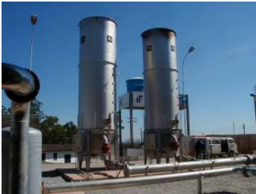
Figura 8: Queimadores (Flares) para a destruição de metano ( \text{CH}_4 ) Fonte: Biogás Energia Ambiental (2008)
