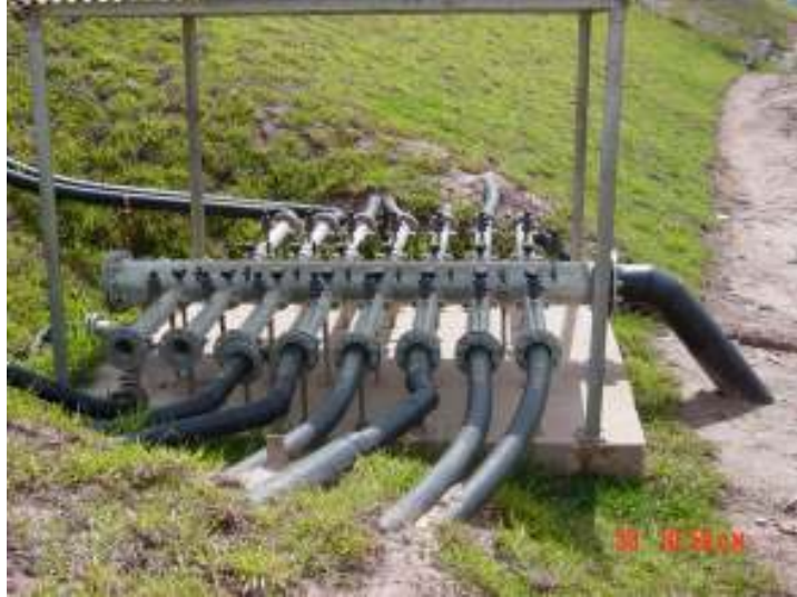
Figura 10: Drenos Verticais para captação do gás Fonte: Acervo Itaú Unibanco (2007)
