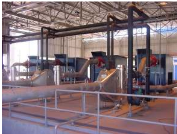
Figura 11: Soprador Blowers Fonte: Acervo Itaú Unibanco (2007)
