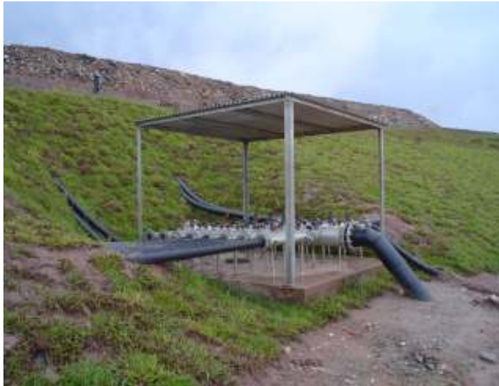
Figura 6: Ligação dos drenos verticais ao sistema de captação Fonte: Biogás Energia Ambiental (2008).
