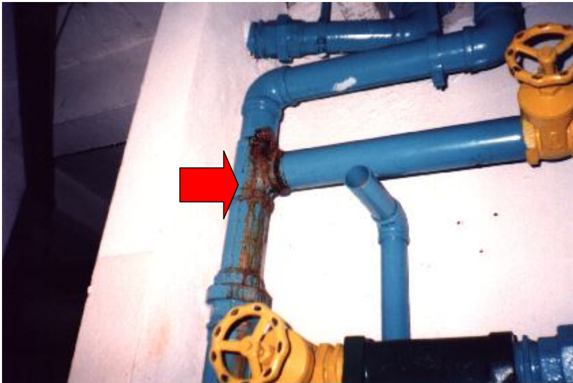
FOTO 8 – Unidade Reguladora de Pressão – Oxidações em roscas
