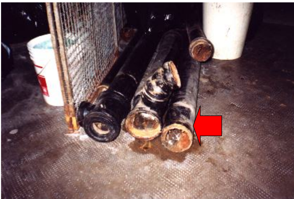
FOTO 6 – Substituição de tubulações de esgoto em ferro fundido por PVC pela falta de manutenção preventiva, impossibilitada por não ocorrer acesso ao interior das tubulações
