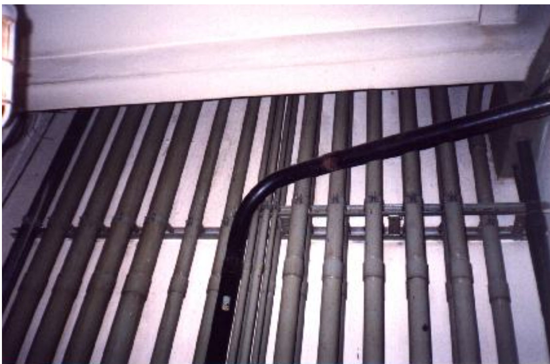
FOTO 1 – Shaft visitável com eletrodutos
