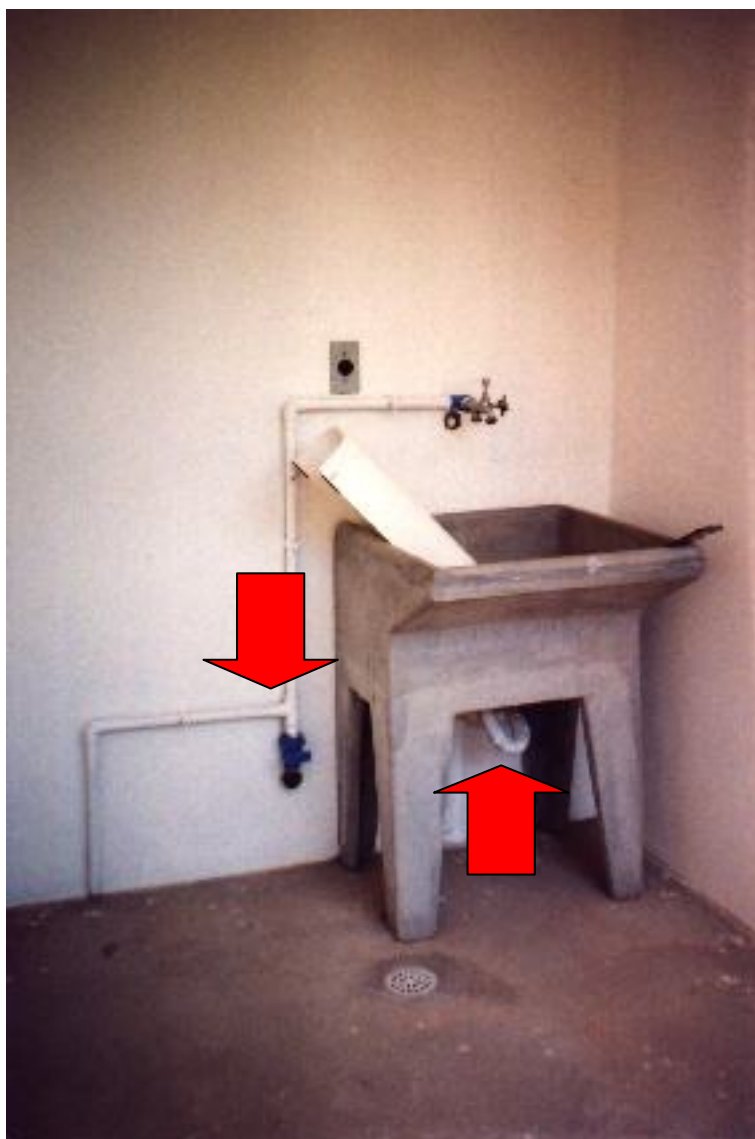
FOTO 10 – Sifão retorcido e tubulações em PVC expostas
