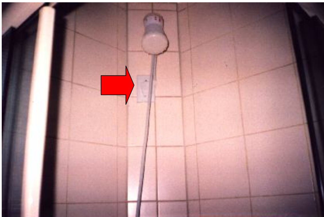
FOTO 11 – Ponto de elétrica do chuveiro – muito baixo
