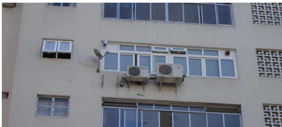
Foto 4 – Exemplo de apartamento com equipamentos modernos e esquadrias antigas
