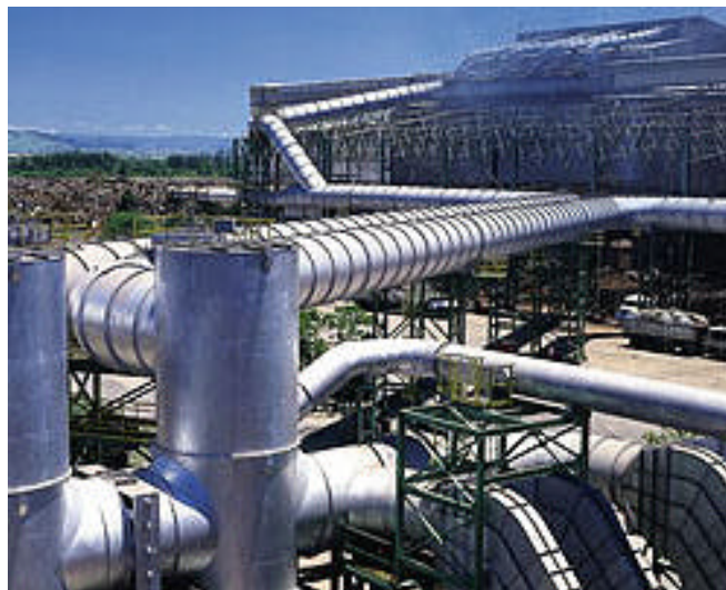
Fotografia 2: Despoeirador de usina siderúrgica.
