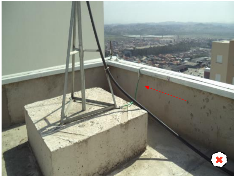
Figura 2: Vista de antena de TV aterrada ao SPDA com cabo de bitola inferior ao permitido pela NBR 5419 (ABNT, 2005)
