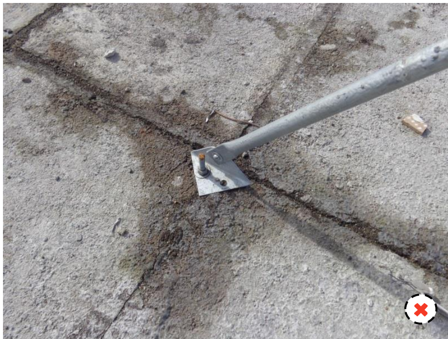
Figura 3: Vista de elemento de fixação do mastro da haste Franklin possivelmente furando a manta de impermeabilização.
